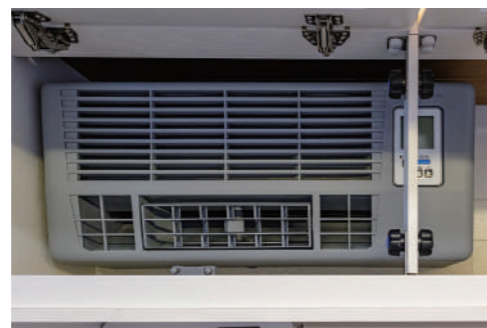
効率の良いDCクーラーが設置され、室内を快適な状態に保つことが可能になりました。
