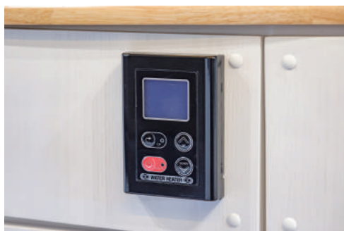
カセットガスを利用した温水ボイラーを設置しました。いつでもお湯が使えて便利です。
